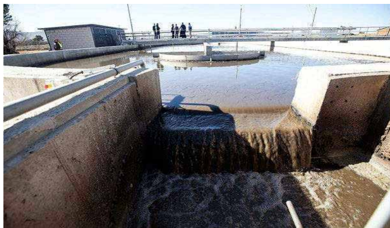
Depuradora construida por Acuaes en Consuegra como parte de la mejora del saneamiento de Las Tablas de Daimiel. / Y. LANCHAS
